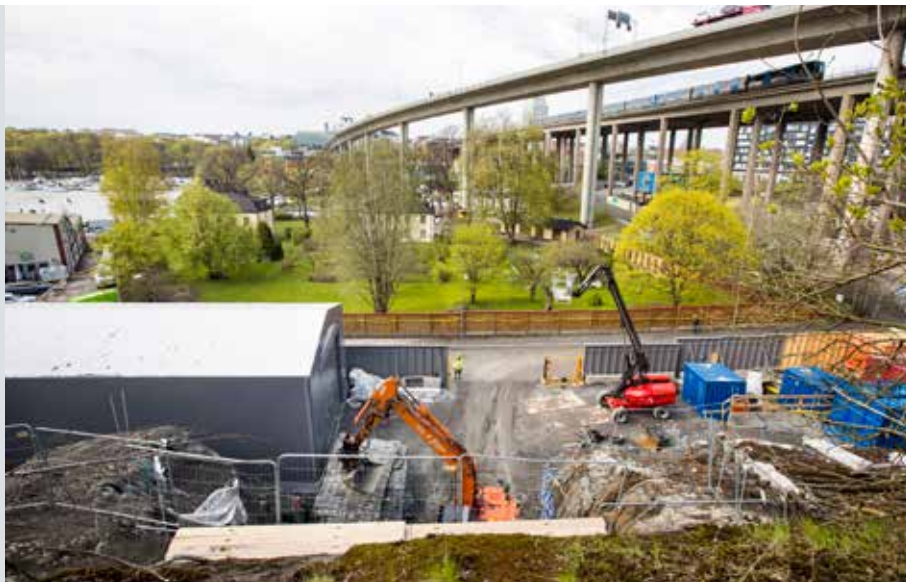
Från byggetableringen vid Sundstabacken norr om Gullmarsplan sprängs en arbetstunnel ned till avloppstunneln fram. Arbetet har pausats sedan september och återupptas i början av mars 2022.
