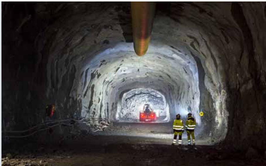
Bilden ovan är tagen mer än 60 meter under marken, precis vid Mälarens strand i Smedslätten. Stockholms nya avloppstunnel är nu beredd att göra sin djupdykning 90 meter under Mälaren.
