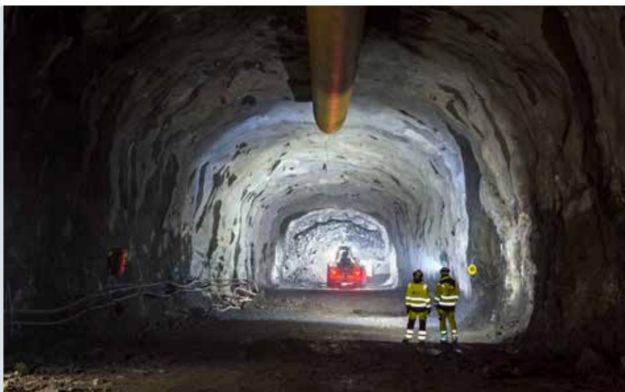
Stockholms nya avloppstunnel växer fram under jorden i Bromma, Hägersten, Årsta och Johanneshov. Nästa stora utmaning är att bygga Mälarpassagen, som djupast 90 meter under Mälarens nivå.
