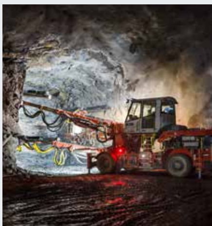
Tunneln byggs genom att borra och spränga i berget djupt nere under marken.
