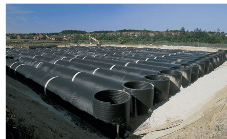
Avsättningsmagasin kan platsgjutats eller anläggas med hjälp av prefabricerade element. Ovan ett rörmagasin i plast.
