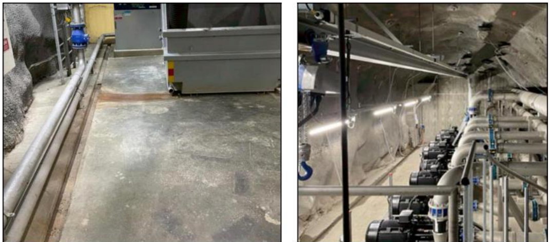
Figur 10 Utrymmen där läns pump 2 (t.v.) respektive läns pump 16 (t.h.) är belägna.
