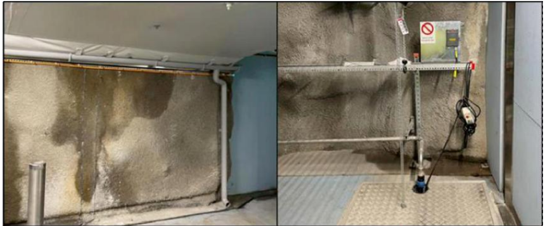
Figur 9 Bilder till utvisande av läns pump 7 (t.h.) respektive vägg i utrymmet där läns pump 7 är belägen (t.v.).
