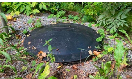
Locket på LTA-anläggning
