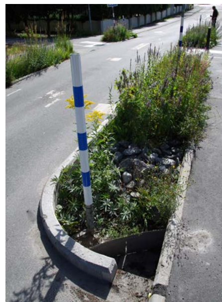
Vattnet leds in i bädden via en öppning i kantstenen.
