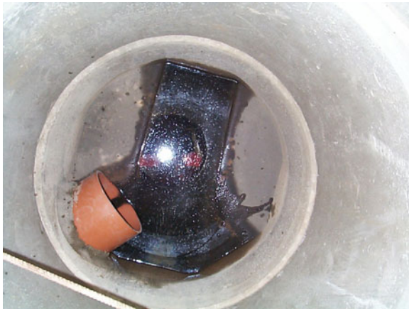
Bräddbrunn inkommande ledning (B). Inkommande flöde från bildens övre kant.
