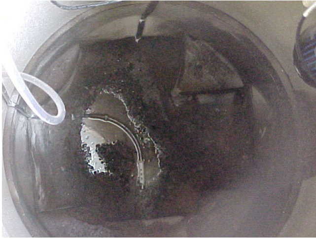
Mätbrunn inkommande ledning (A). Inkommande flöde från bildens övre kant.
