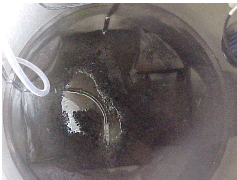
Figur 2 Installationsbrunn för inkommande ledning: Logger för ADS flödesmätare syns i bildens övre högra hörn. Kablar till givare som installerades i inkommande ledning kan ses i bildens övre kant. Slang för provtagning med tillhörande munstycke för insug av vatten monterades i botten av brunnen. Inkommande ledning från höger är pluggad.
